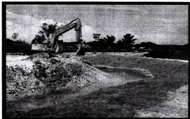
Obra de adequação para macro drenagem na sede de Rorainópolis. Fonte: Adan Santos
