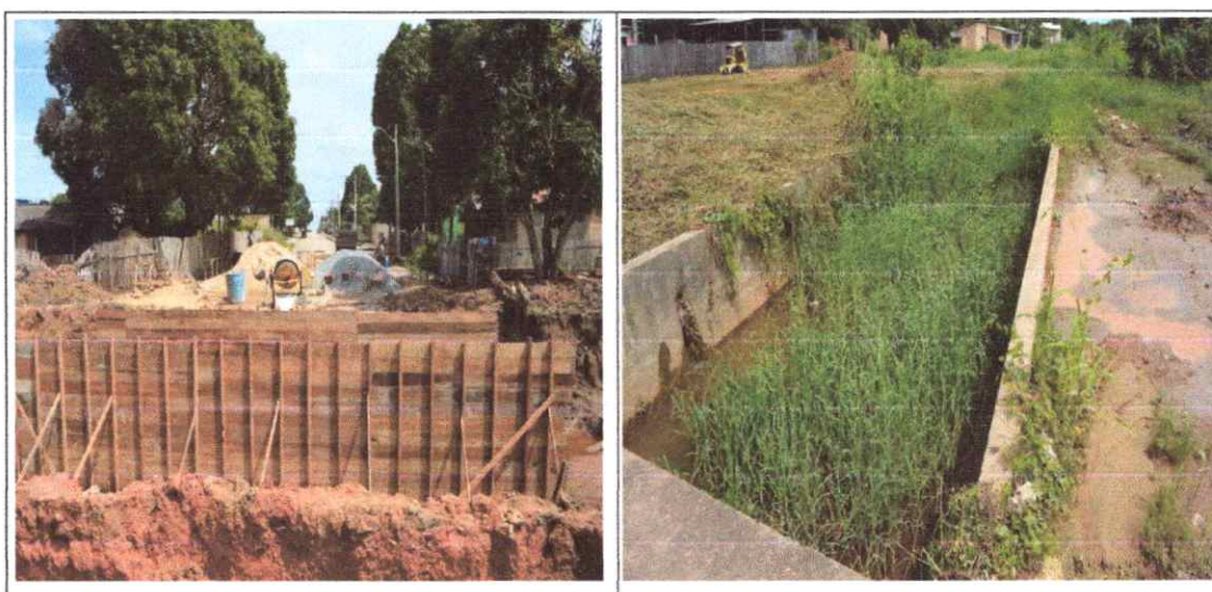
Figura 32 – Canais de drenagem existentes em Rorainópolis (Sede), o da esquerda em construção (Bairro Novo Brasil) e a direita totalmente assoreado (Centro), Igarapé Chico Reis.
