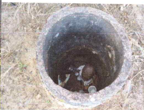
Rede coletora de esgoto sanitário
