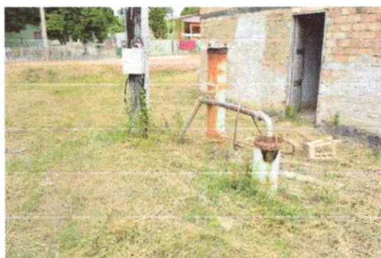
Poço artesiano (Sede)
